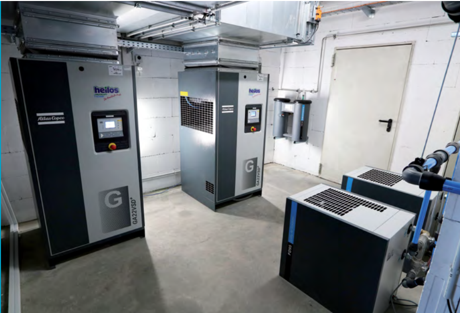
◀ Die neue Druckluftstation besteht aus zwei kompakten, drehzahlgeregelten Schraubenkompressoren des Typs GA 22 VSD* (links im Bild) sowie zwei FD-Kältetrocknern (Bild unten).
