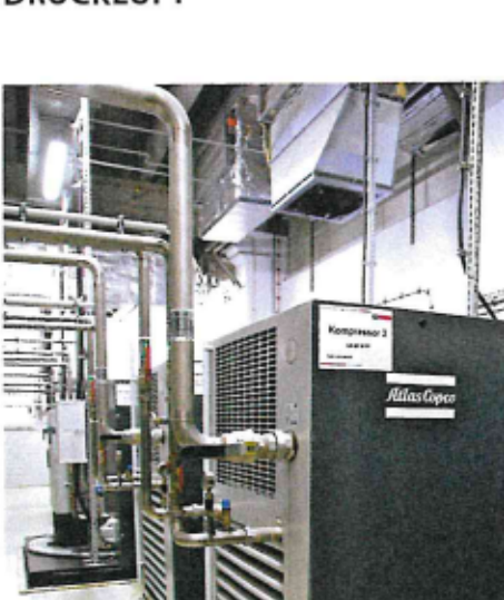
Einer der sechs Kompressoren ist luftgekühlt. Die anderen Maschinen sind wassergekühlt und an das Kühlsystem der Papierproduktion angeschlossen.
